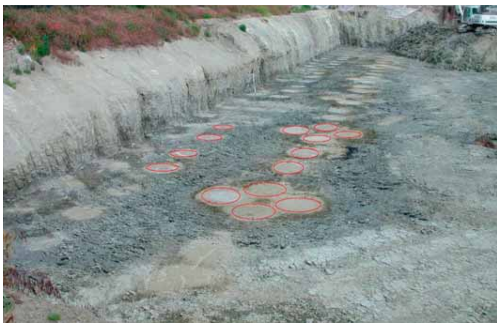
Auto Club BMW Modena – consolidamento fondazioni e muro a gravità in fregio alla Via Emilia
